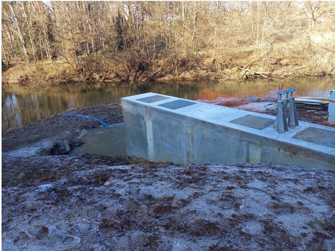
Nouvelle prise d'eaux brutes – LE VIGEN
