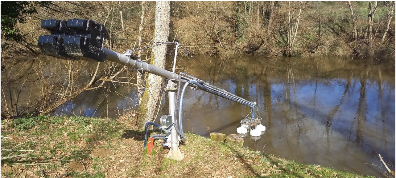
Bras de prélèvement eaux brutes en amont de la prise d'eau en Briance – station alerte pollution
